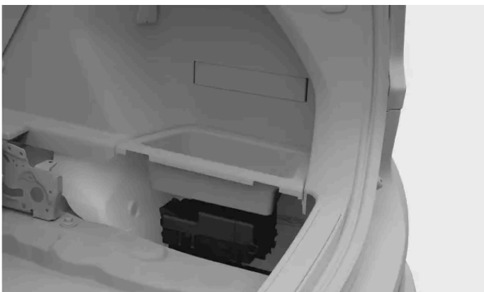
Lage des Sicherungskastens
